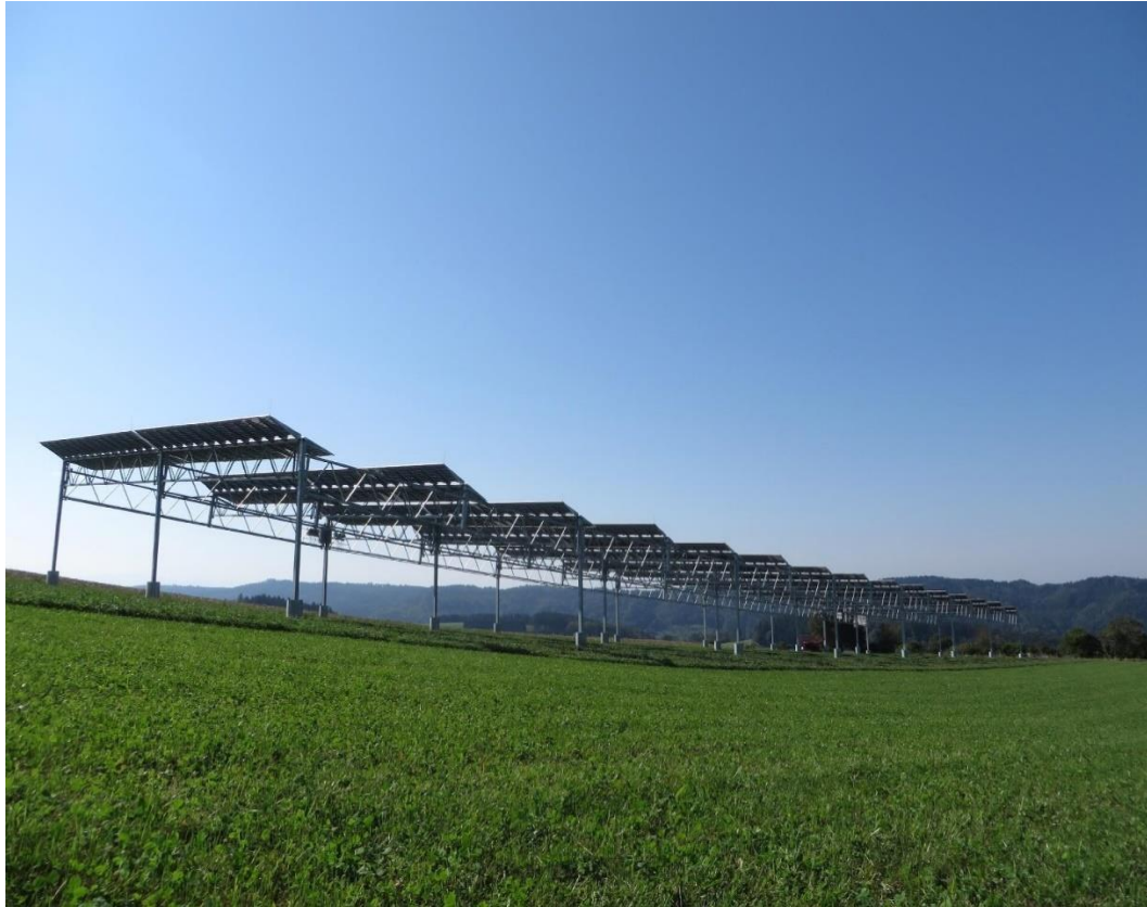
Abbildung 22: Hoch aufgeständerte APV-Anlage. Die Module sind etwa fünf Meter über dem Ackerboden montiert, so dass der Mähdrescher darunter durchfahren kann. Diese Konstruktion ermöglicht eine vollwertige maschinelle Bewirtschaftung der Fläche. (Fraunhofer ISE 2016).
