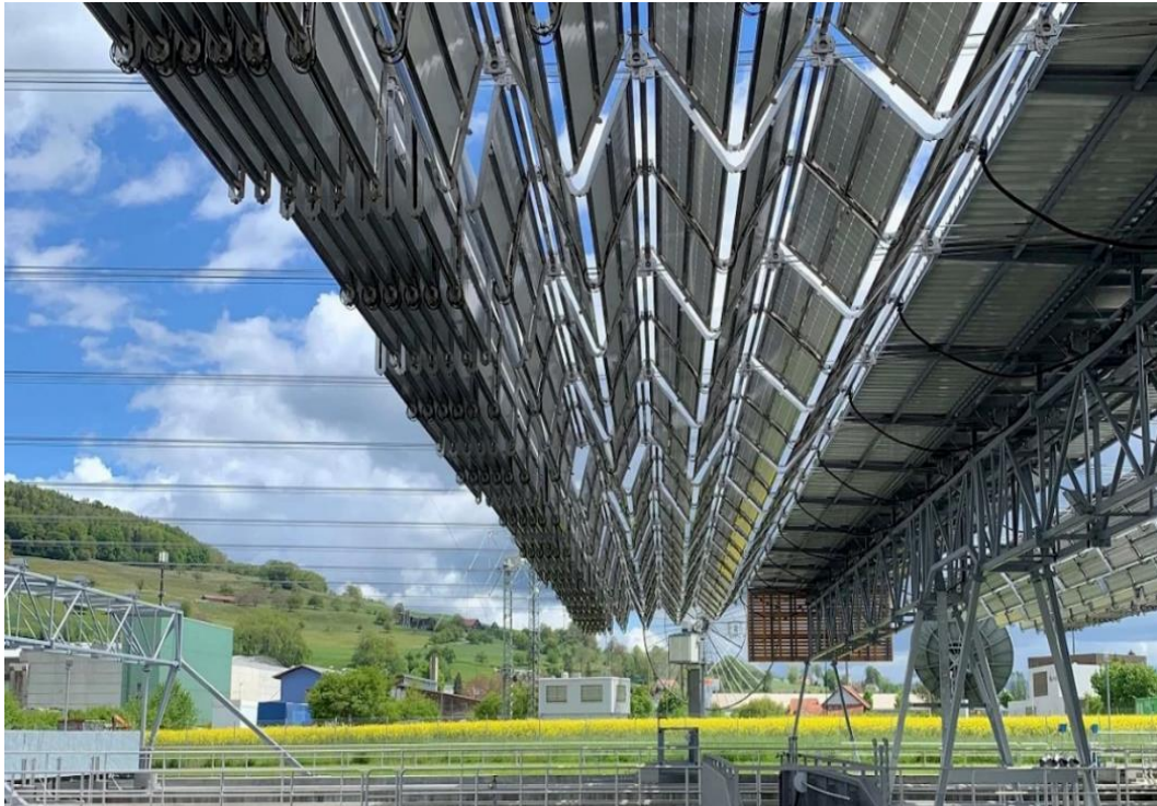
Abbildung 29: Innovatives faltbares Solardach-System (Horizon-System) der DHP Technology (Schweiz) (dhp technology AG o. J.).
